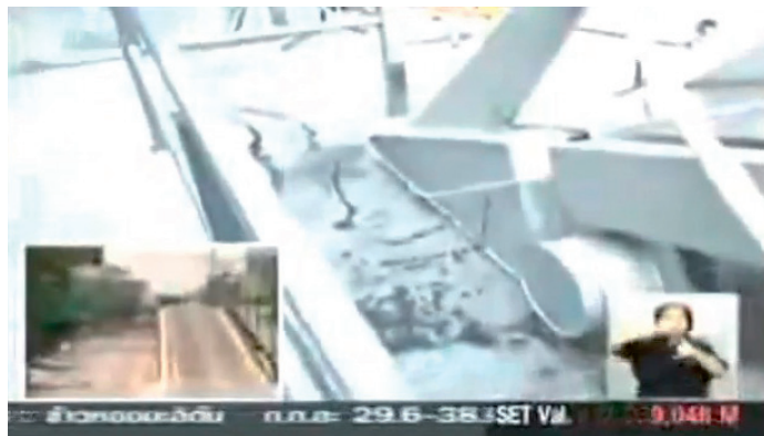
บริเวณทางลัดลิฟท์ รถไฟฟ้าใต้ดินสวนลุมพินี ฝั่งสวนลุมฯ ใกล้ลานพระรุชฎกาลที่ 6 ในภาพยังเห็นคราบเลือด
